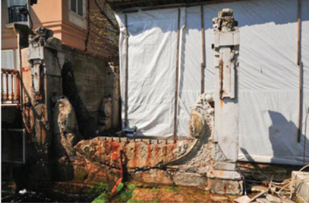
Resim 16. Ön döküm cephe elemanları (onarım öncesi)
