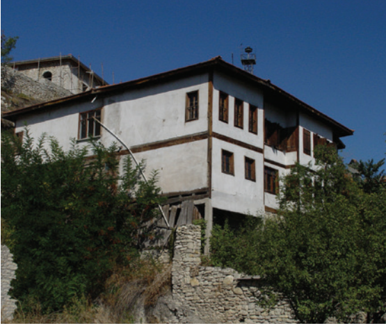
Resim 3. Restorasyon öncesinde konağın durumu (Ön köşede zemin boşalması nedeniyle yapının oturması, arkasından yanlış bir uygulamayla konağa eklenen taş payanda ve betonarme destek görülmektedir. Çatı ise tümüyle bozulmuş ve artık yağmur suyunu engelleyemez duruma gelmiştir. Resim, pencerelerin açılım şekli ve boyutlarındaki değişikliklere dikkati çekmektedir.)
