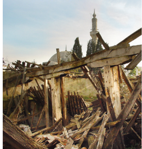
Resim 2. Silivri, Piri Paşa Kervansarayı'nda çöken çatıyı taşıyan ahşap dikmeler ve başlıkları
