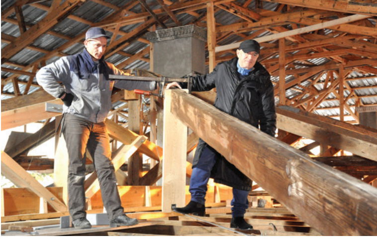
Resim 18. İslatma sonrası kirişin durumu
