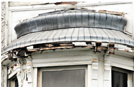
Resim 4. Hasar görmüş ahşap cephe elemanları
