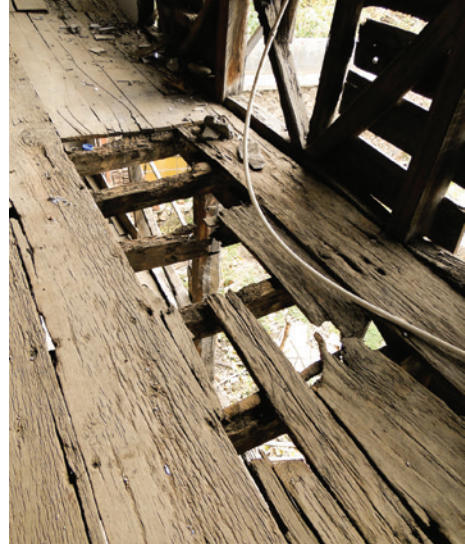
Resim 7. Bursa, Cumalıkızık'ta çürümüş ahşap döşeme ve kirişler
