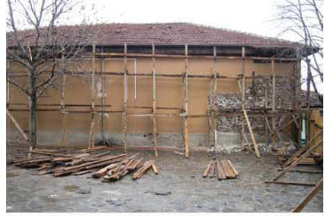
Resim 15. Cumalıkızık Camii sıva raspası
